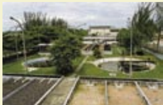
Estação de Esgoto do Aeroporto do Galeão Sewerage station at Rio de Janeiro Galeão Airport
